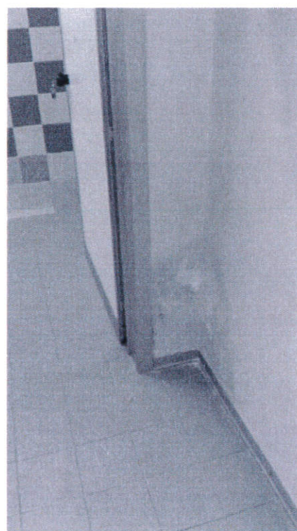
foto 14: Umidità da risalita, esterni ed interni
